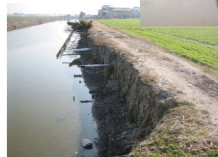
崩壊状況(国営)
