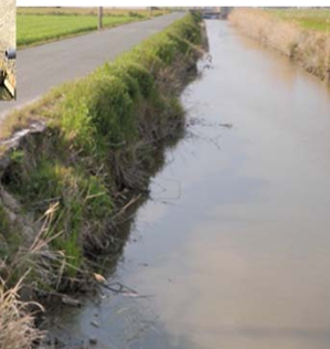
崩壊状況(県営)
